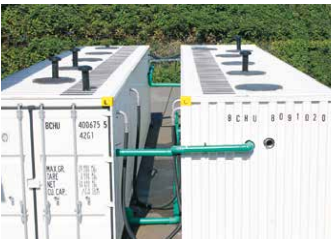
Fig. 1: Planta de tratamiento de 40 pies para un campo de exploración petrolera de 160 trabajadores en Siberia.
